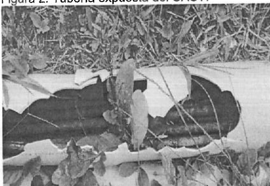
Figura 2. Tubería expuesta del CAST.
