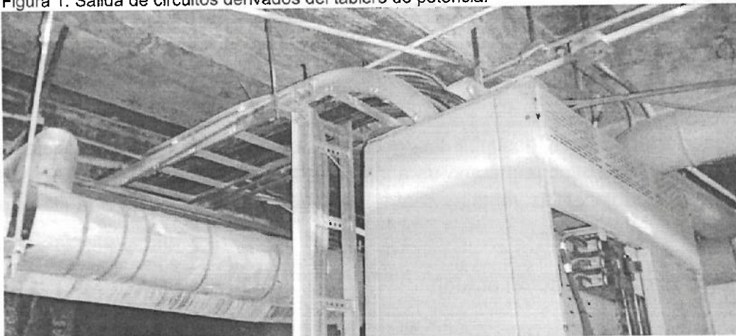
Figura 1. Salida de circuitos derivados del tablero de potencia.
