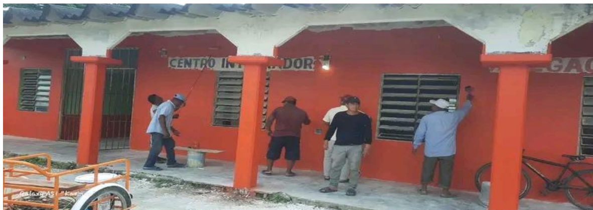
Ilustración 5 AQUI SE PUEDE OBSERVAR EL CENTRO DE INTEGRADO DE QUINTIN ARAUZ EN MANTENIMIENTO POR MAL ESTADO
