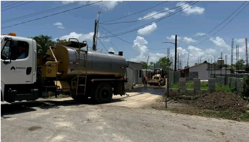
Ilustración 7 EN ESTAS DOS IMAGENES PODEMOS OBSERVAR OBRAS DE REPARACION DE CALLES INCONCLUSAS Y MATERIALES DE BAJA CALIDAD
