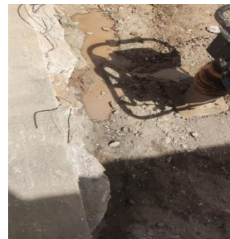
Foto Compactando zanja de drenaje y salía agua de las fugas.
