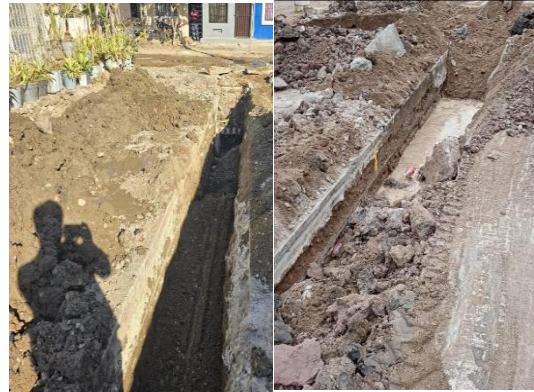
Foto Tapando la zanja del drenaje con fugas evidentes y escombros.
