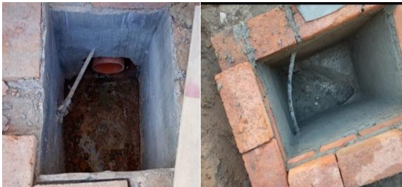
Foto Manguera de agua potable atravesada por los registros de las casas 3624, 3622 y 3610.
