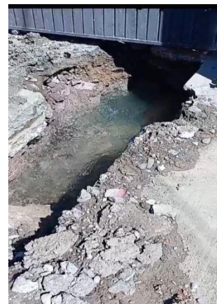
Foto Fuga de línea de agua potable.
