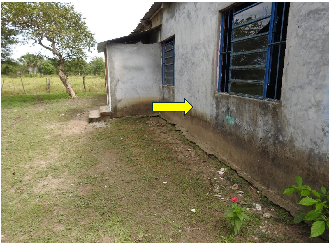
Figura 28. Marca del nivel de agua que alcanza la inundación en épocas lluviosas. Municipio de Jalpa de Méndez.
