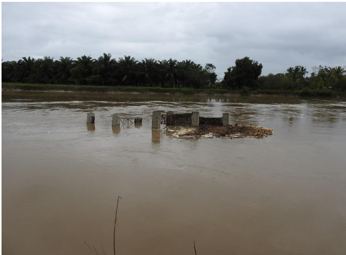
Figura 32. Daño a infraestructura cuando incrementa el nivel del agua del río de la Sierra e inunda áreas aledañas. Municipio de Jalapa. Fotografía de Ricardo Collado Torres.
