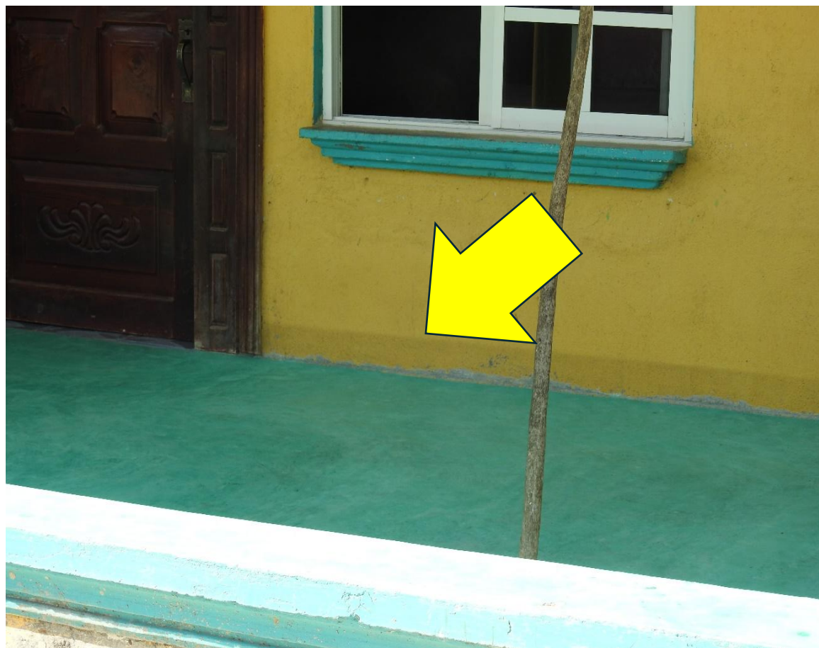
Figura 28. Marca del nivel de agua que alcanza la inundación en épocas lluviosas. Municipio de Nacajuca. Fotografía de Ricardo Collado Torres.
