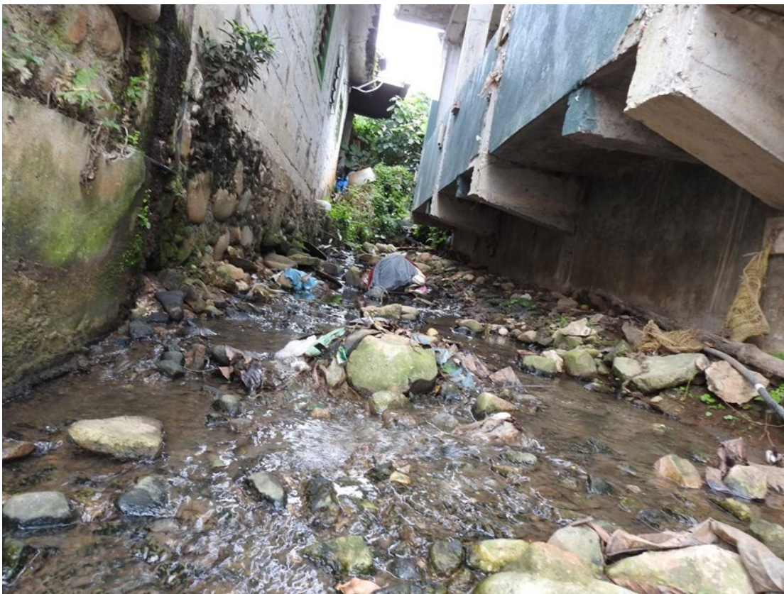
Figura 30. Construcciones comunes en la ciudad de Teapa, que además de exponerse a escurrimientos intensos y erosión de las construcciones, es refugio de fauna nociva y basura. Municipio de Teapa. Fotografía de Ricardo Collado Torres.
