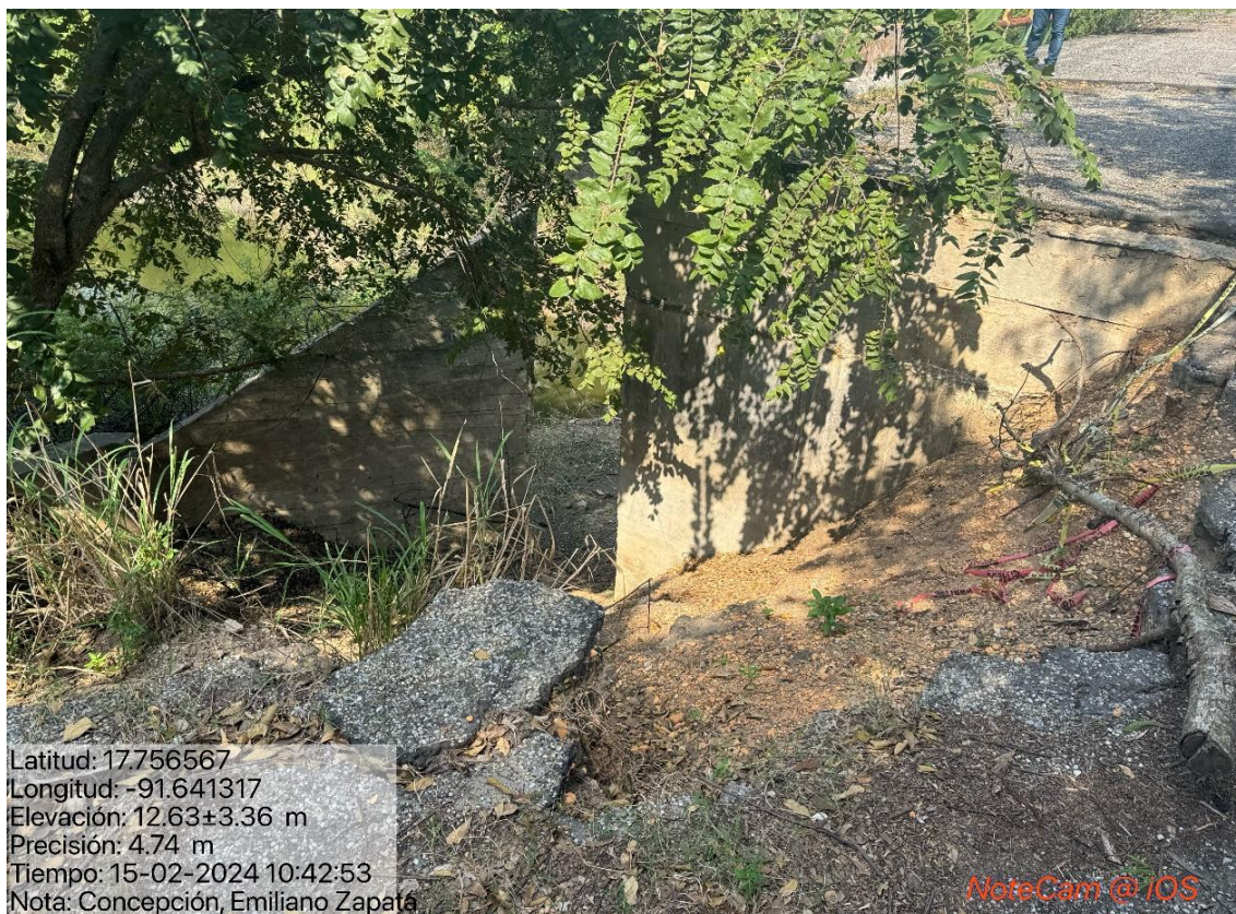
Figura 32. Daño a infraestructura en camino al poblado Concepción, cuando incrementa el nivel del agua en la zona. Municipio de Emiliano Zapata. Fotografía de Ricardo Collado Torres.
