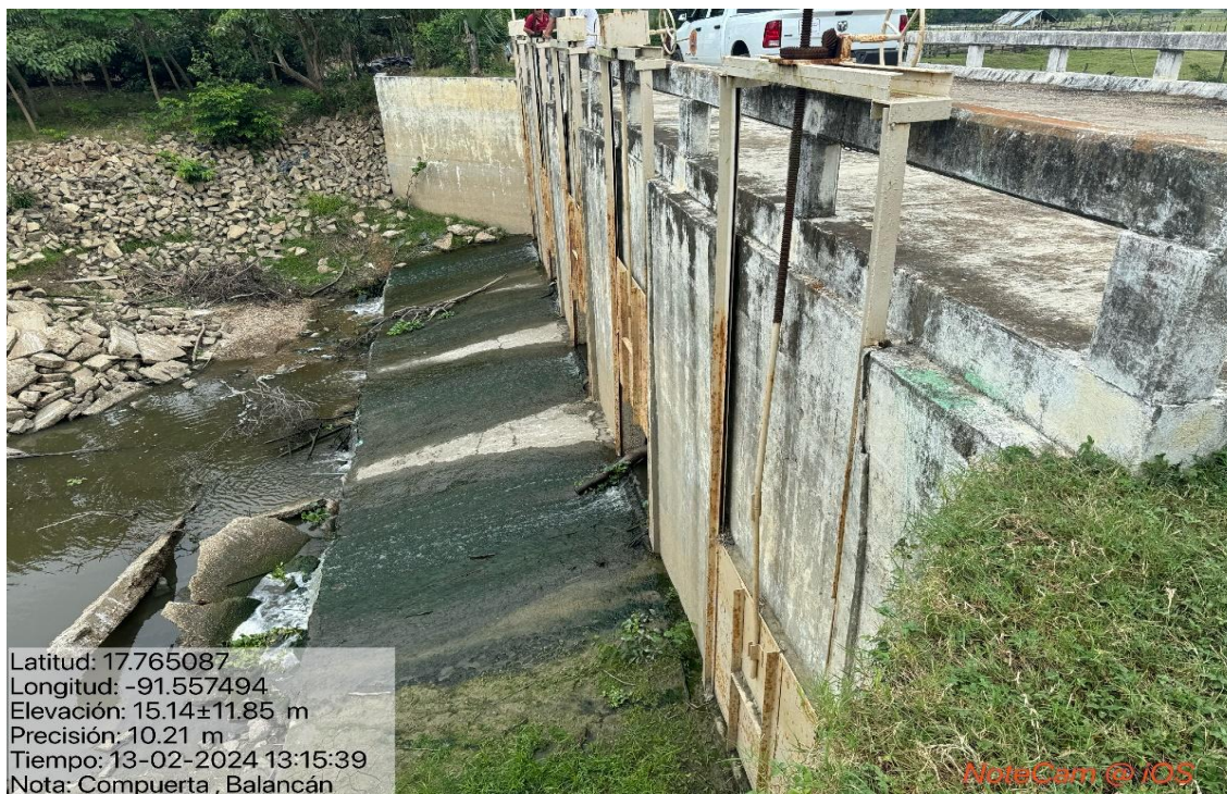
Figura 32. Compuerta de control de escurrimientos en época lluviosa y de inundaciones, al sur de la ciudad de Balancán.
