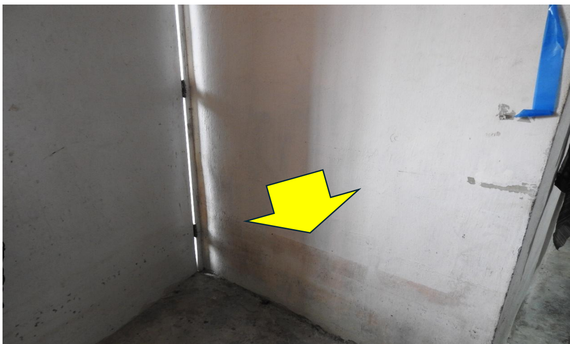
Figura 30. Nivel de inundación marcada en una vivienda del poblado Multé, Balancán. Fotografía de Ricardo Collado Torres.
