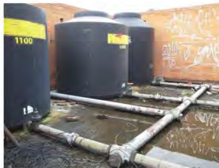
Imagen 4.- Se observan tinacos y red hidráulica interna.
