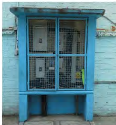
Imagen 7.- Muro de acometida donde se observa el interruptor general y el tablero de distribución.
