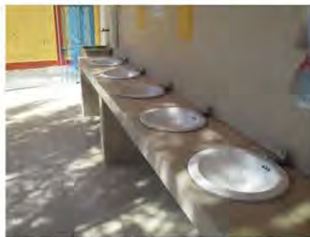
Imagen 12.- Mesetas de concreto con lavamanos.
