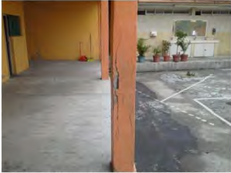
Imagen 19.- Se observan grietas mayores a 0.5 milímetros en las columnas.
