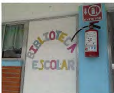
Imagen 23.-Fotografía del señalamiento y extintor.
