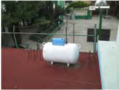
Imagen 8.- Instalación de gas, con tanque estacionario para almacenamiento.
