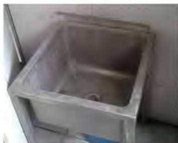
Imagen 14.- Se observa vertedero en estado regular.
