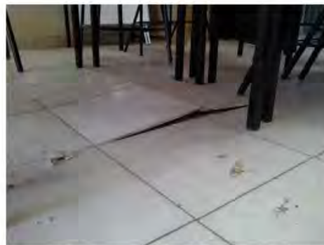
Imagen 18.- Se observa piso de loseta en mal estado, ya que se encuentra levantado.
