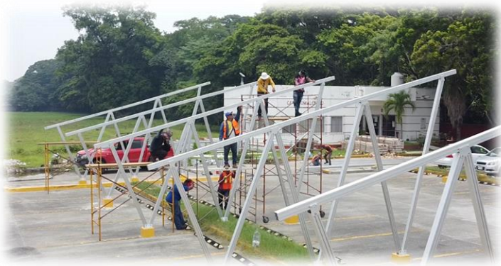
584 paneles de 460W.
