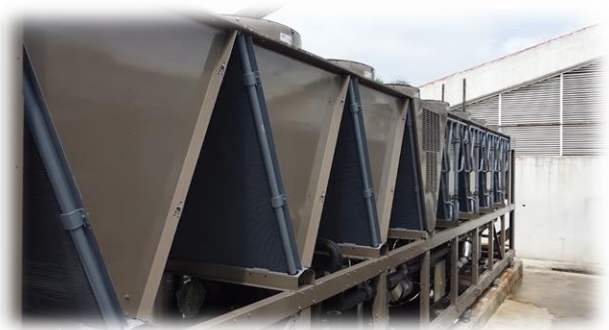
Unidad Generadora de Agua Helada (Chiller) enfriando por Aire de 370TR
