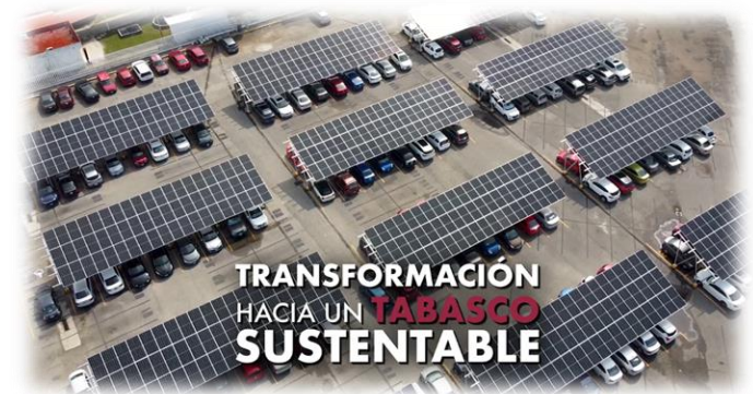
Sistema Fotovoltaico de 362.94 KWp, que comprenden 789 paneles de 460W.
