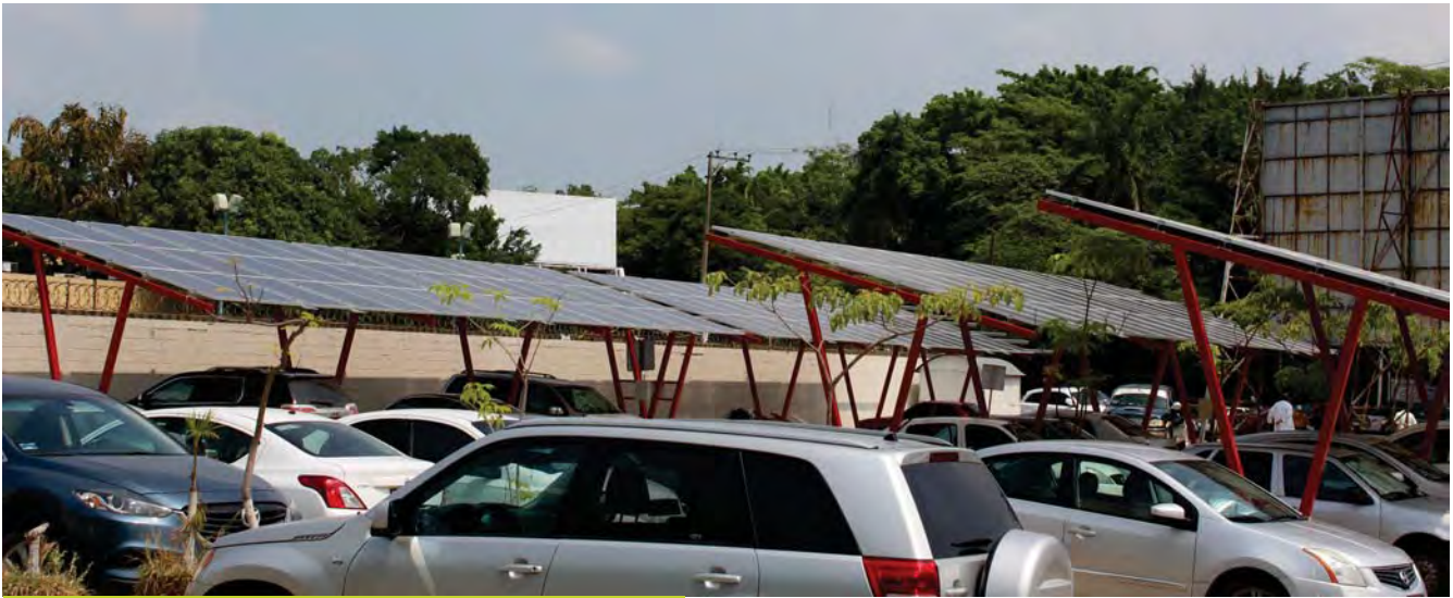
Sistema fotovoltaico en la UMF de Centro
