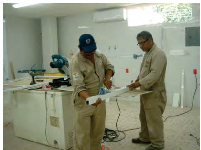
Acondicionamiento de espacios de atención médica
