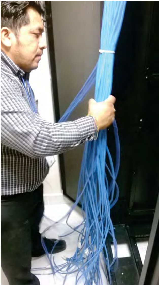
Cableado de redes de comunicación
